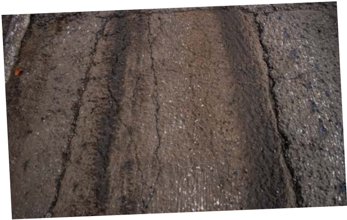
Scheurtjes in het asfalt
