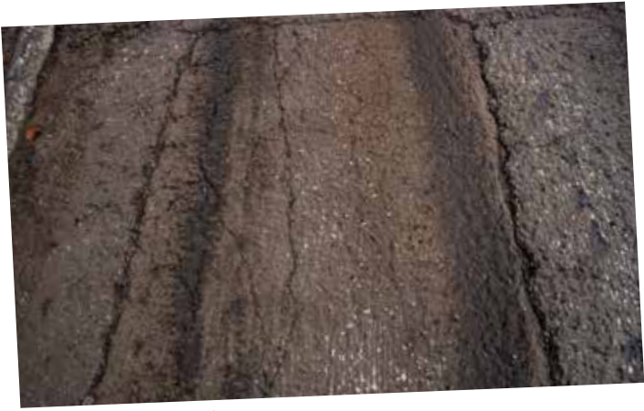
Scheurtjes in het asfalt
